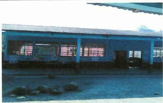
Foto 3: Sustrucción de puerta en aula que no cierra correctamente.
