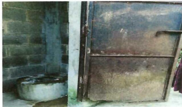
Foto 2: Sustrucción de puertas de sanitarios debido a deterioro del metal.
